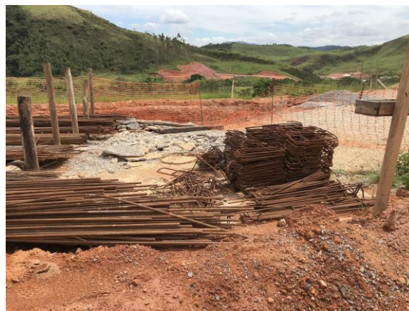
Ferragens que deveriam ser usadas nas estruturas de casas de concreto armado próximo à Praça Santo Antônio (Área 1) danificadas devido à exposição ao sol e chuvas. Data: 25/02/2021 . Fonte: Assessoria Técnica Cáritas.
