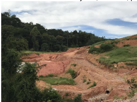
Trecho próximo à Rua Furquim (Área 2) com serviços de terraplanagem necessários, mas sem nenhum trabalhador. Data: 25/02/2021 . Fonte: Assessoria Técnica Cáritas.
