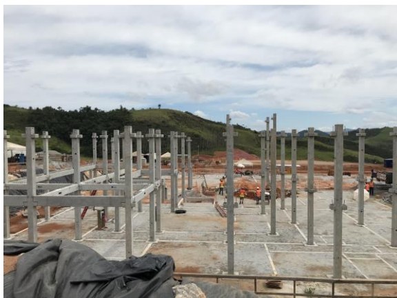
Estrutura da escola municipal situada à Praça Santo Antônio, sem trabalhadores em quantidade suficiente. Data: 25/02/2021 . Fonte: Assessoria Técnica Cáritas.
