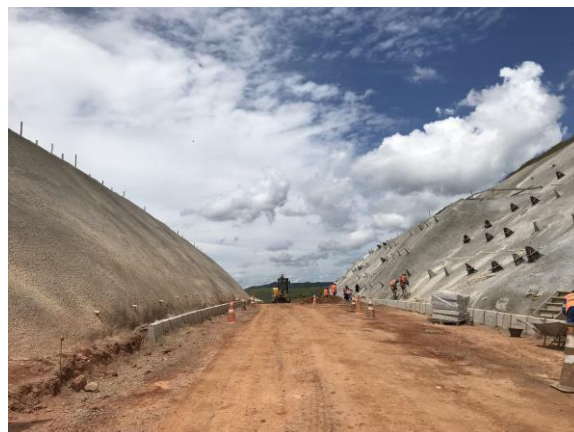
Contenção dos taludes na “trincheira” - acesso principal, sem trabalhadores em quantidade suficiente. Data: 25/02/2021 . Fonte: Assessoria Técnica Cáritas.
