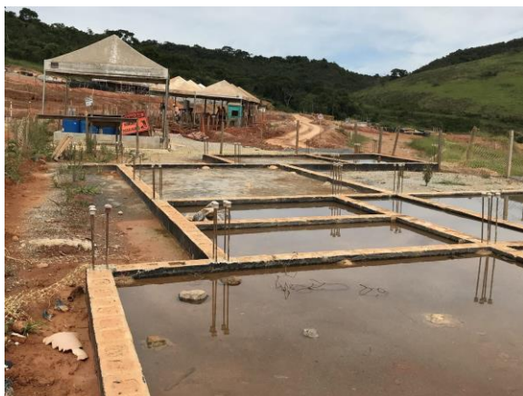
Casa com fundações mal executadas próximo à Praça Santo Antônio (Área 1), sem nenhum trabalhador e com água empoçada (risco de dengue). Data: 25/02/2021 . Fonte: Assessoria Técnica Cáritas.
