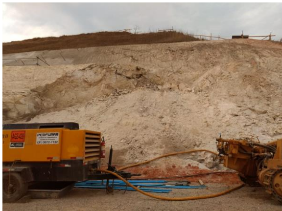
Deslizamento de terra em talude situado no acesso principal. Data: 08/10/2020 . Fonte: Assessoria Técnica Cáritas.
