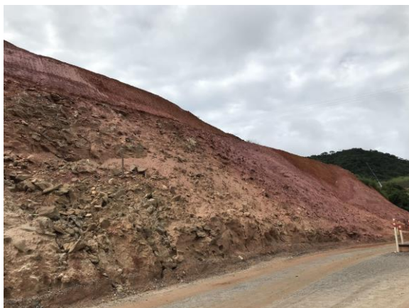
Encosta ainda sem execução de contenção e proteção. Data: 22/02/2021 . Fonte: Assessoria Técnica Cáritas.
