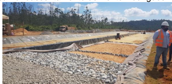
Estação de Tratamento de Esgoto. Data: 30/01/2020 . Fonte: Assessoria Técnica Cáritas
